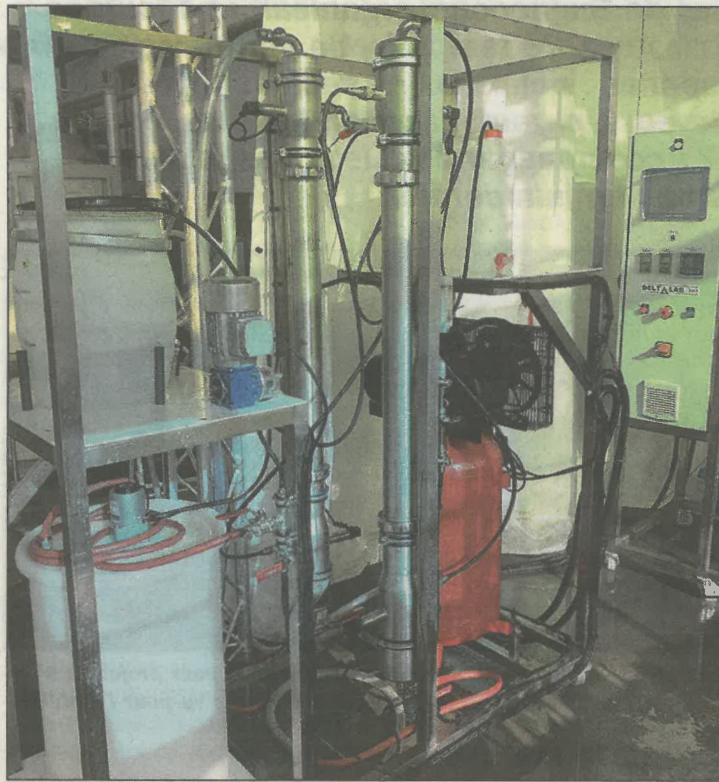
Pilote mobile de stripping pour produire du sulfate d'ammonium.
